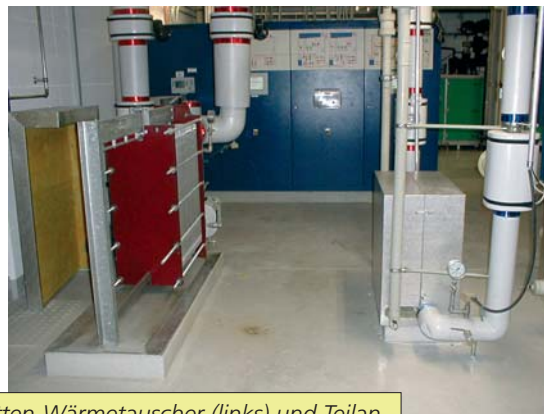
Platten-Wärmetauscher (links) und Teilansicht der geothermischen Heizzentrale von Lavey-les-Bains (Foto G. Bianchetti)
